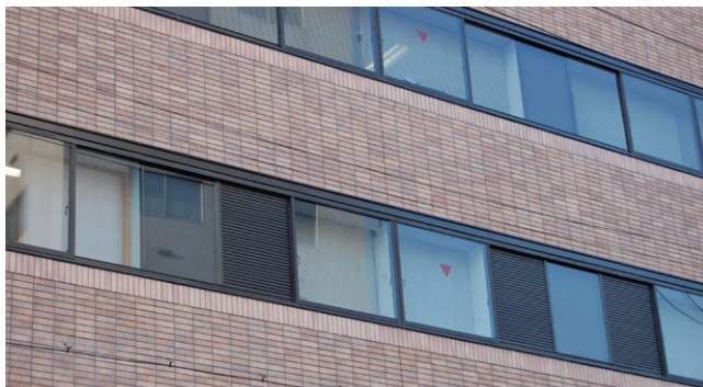
外壁タイルは剥離が大きな問題
