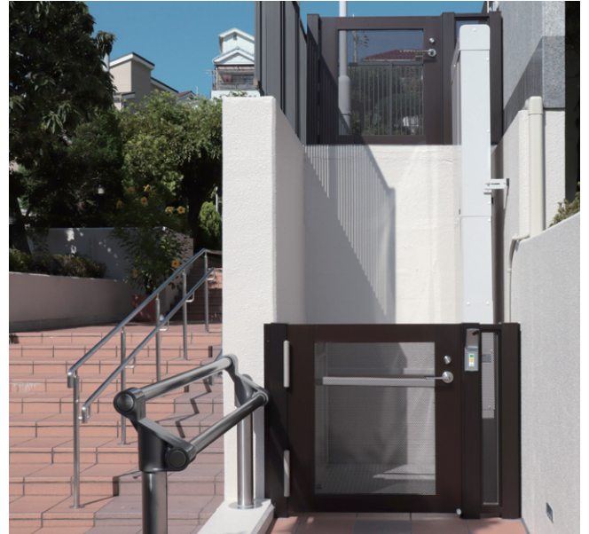
エントランスに設置された昇降機
